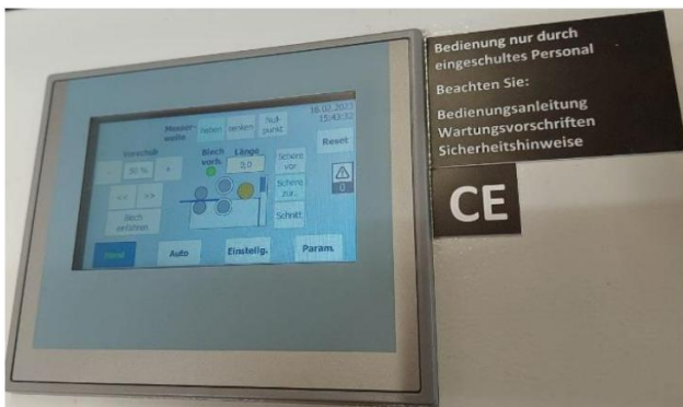
Steuerung Touch Screen (Siemens Steuerung)
