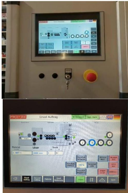
Steuerung per Display
